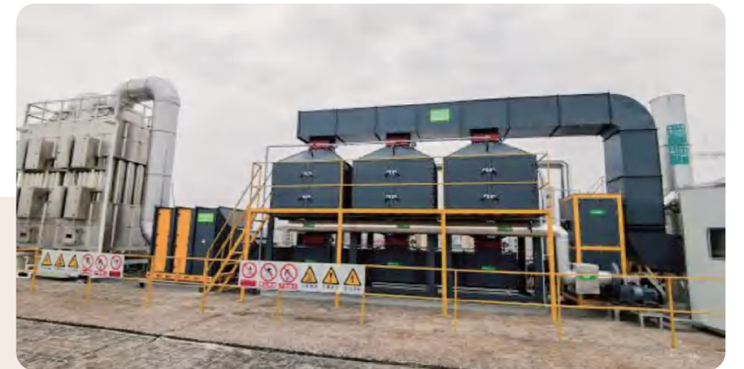
立式静电除油+分子筛吸附脱附+CO催化燃烧、臭氧治理设施
